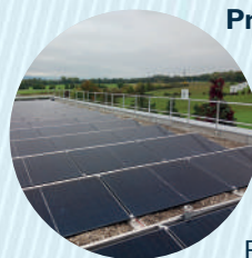
Usine d'eau potable
