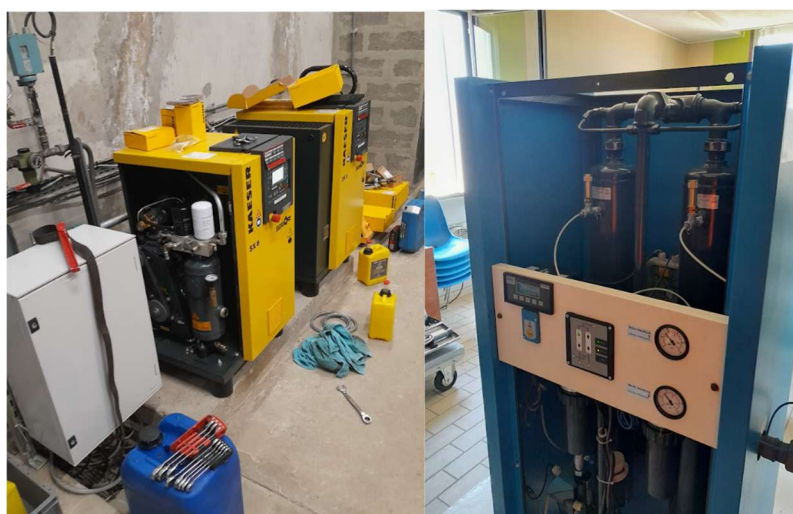
Photos des maintenances sur les compresseurs et sécheurs d'air des ozoneurs
