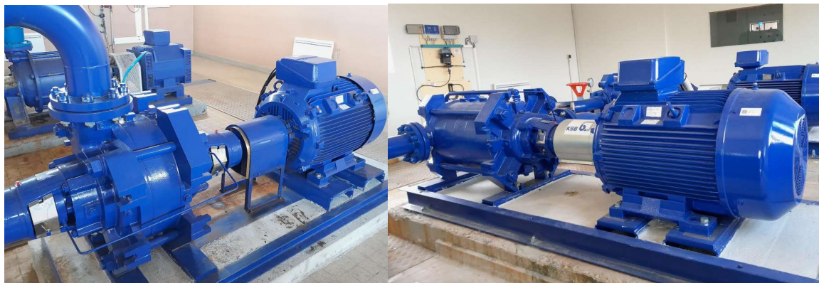
Photos de pompes renouvelées
