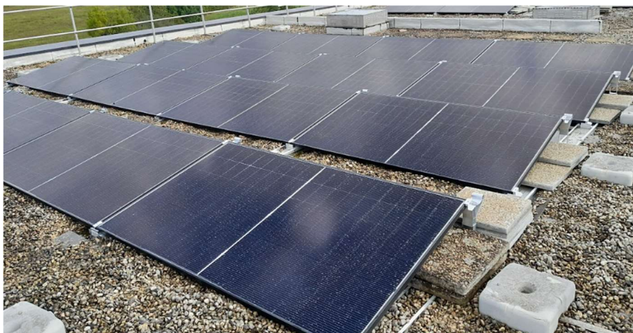
Photo de panneaux photovoltaïques
