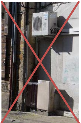
Appareils divers en applique sur la façade
