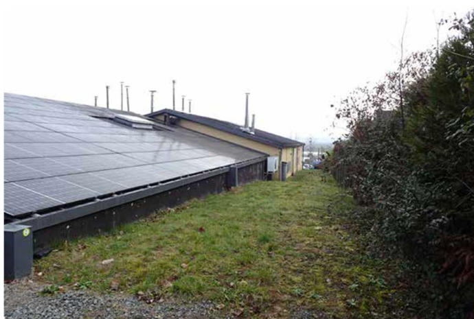
Panneaux couvrant la totalité de la surface d'un hangar de stockage pour une boulangerie, Limas
