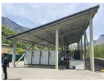
Abri pour stockage de batteries, Isère
