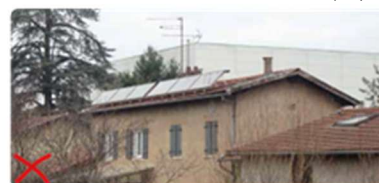
Panneaux sur châssis sur un toit en pente, à proscrire
