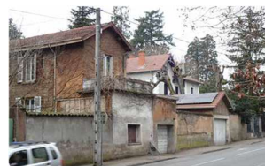
Au sein du SPR de Villefranche, panneaux implantés sur une annexe basse plutôt que sur le volume principal haut. L'encastrement plutôt qu'une surimposition aurait rendu l'installation plus discrète
